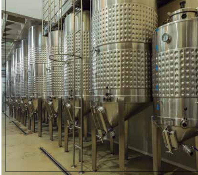
Tanques de aço inox
